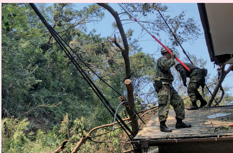
台風15号被害 鎌倉初の自衛隊による災害派遣を受けた二階堂のがけ崩れ。避難所の開設、発電機の準備、食事の用意など現地でお手伝いさせていただいた。
