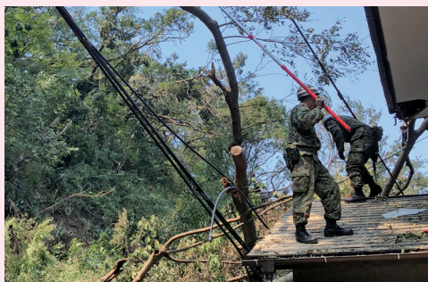
台風15号被害 鎌倉初の自衛隊による災害派遣を受けた二階堂のがけ崩れ。避難所の開設、発電機の準備、食事の用意など現地でお手伝いさせていただいた。
